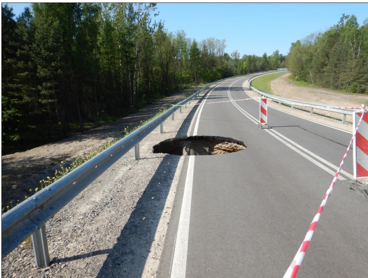
Rys. 2. Lokalizacja zapadliska w korpusie drogi
