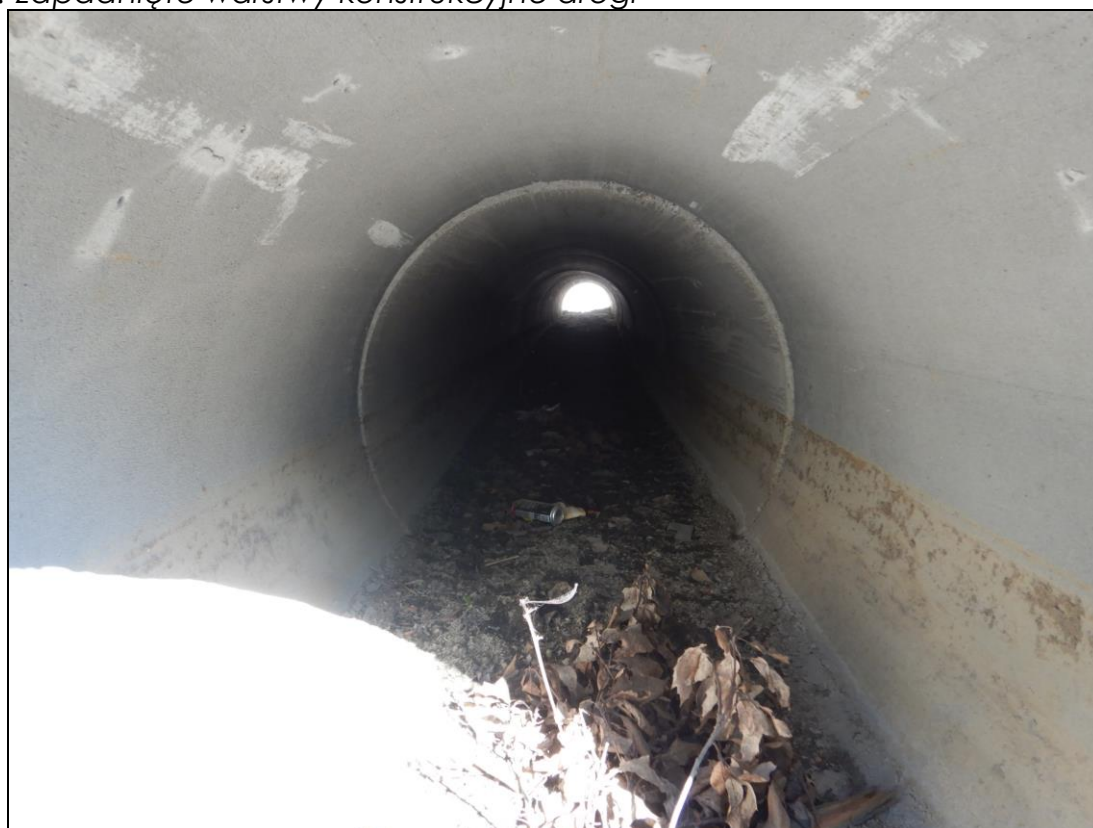
Rys. 4. Przepust drogowy poniżej powstałego zapadliska
