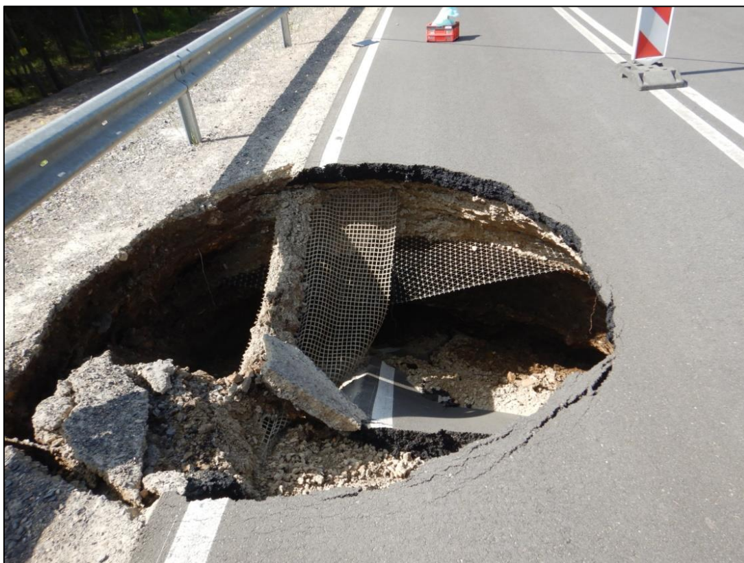
Rys. 3. Zapadnięte warstwy konstrukcyjne drogi
