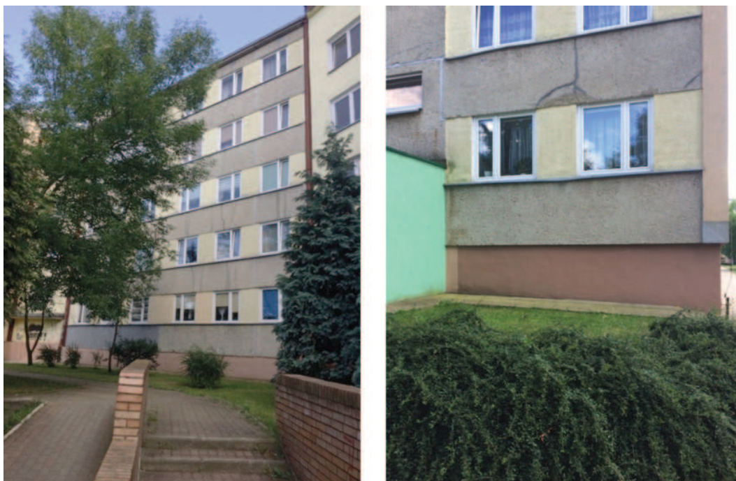
Rys. 5. Przykład zarysowań warstwy fakturowej ściany zewnętrznej w budynkach wielkopłytowych /źródło: J. Szulc/
