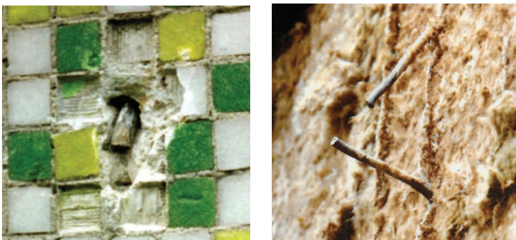
Rys. 9. Przykłady pęknięcia wieszaków stalowych warstwy fakturowej ścian zewnętrznych /źródło: M. Wójtowicz [8]/
